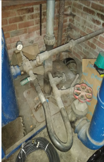
Foto No. 3. Vista general del pozo
