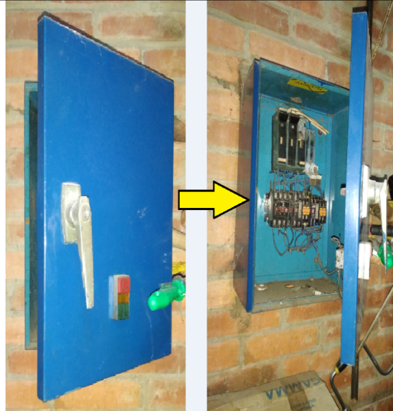
Foto No. 4. Sistema eléctrico deshabilitado
